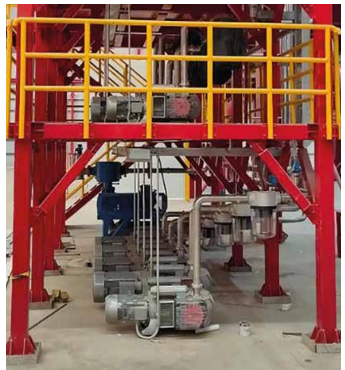
Rys. 4. Transport pneumatyczny w zakładzie produkcji kawy. System wykorzystuje pompy próżniowe i dmuchawy PD do pchania i wciągania materiałów
