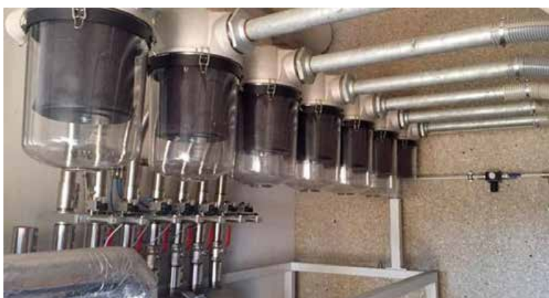
Rys. 6. Zestaw filtrów z serii Solberg ST chroni pneumatyczny system transportu materiałów pochodzących z recyklingu w fabryce wytłaczania tworzywa sztucznego
