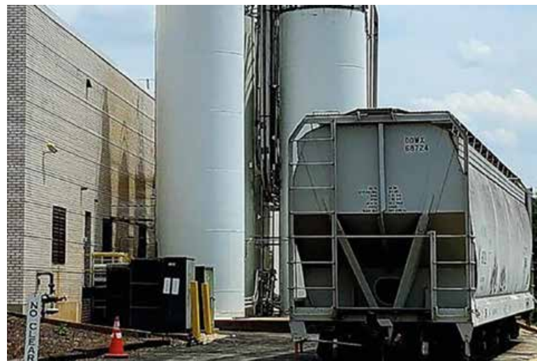
Rys. 2. Ten zakład formowania wtryskowego wykorzystuje system transportu pneumatycznego do rozładunku granulatu tworzyw sztucznych z wagonów kolejowych do silosów magazynowych i dystrybucyjnych
