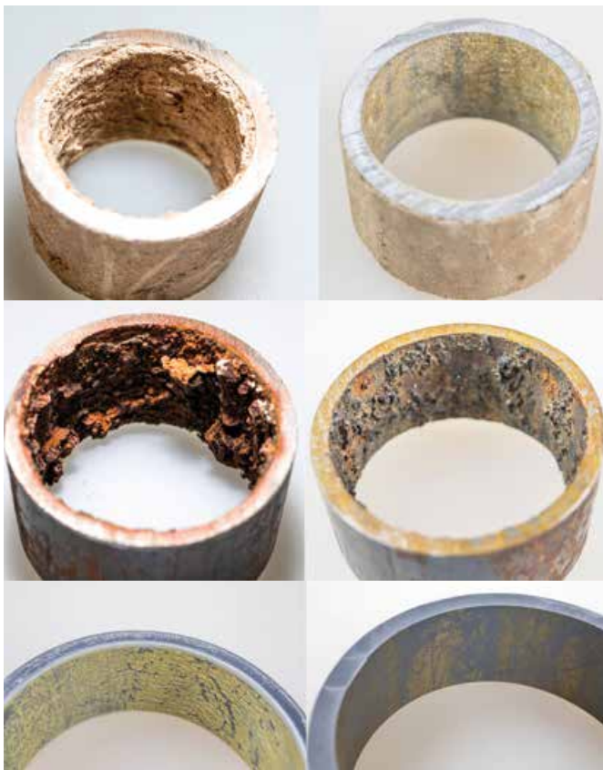
Rys. 1. Zdjęcia wycinków rur z osadem kamienia kotłowego, korozji i biologii przed zastosowaniem systemu VGT ATS oraz po czterech miesiącach stosowania uzdatniania VGT ATS
