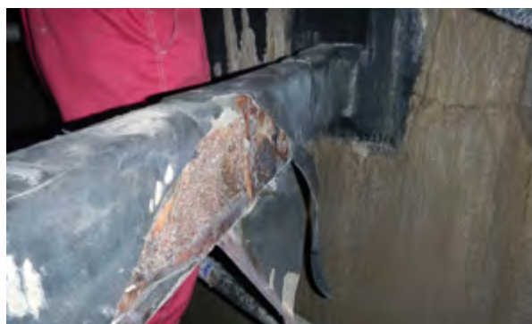
Fot. 6. Uszkodzenie mechaniczne powłoki gumowej. Widoczna stalowa powierzchnia zaatakowana przez procesy korozyjne. Źródło: „Energopomiar” Sp. z o.o.
