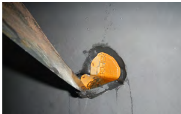
Fot. 2. Przekrój bąbla utworzonego w powłoce gumowej. Widoczny wyciek wody. Źródło: „Energopomiar” Sp. z o.o.
