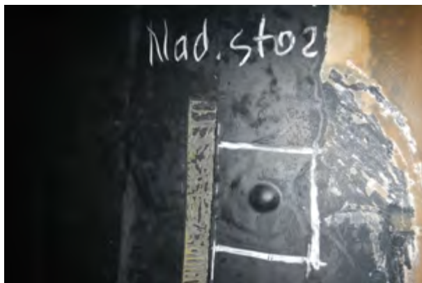
Fot. 1. Wybrzuszenie gumy. Źródło: „Energopomiar” Sp. z o.o.
