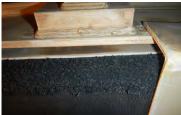
Fot. 5. Uszkodzenie powłoki gumowej na skutek niekorzystnego oddziaływania zbyt wysokiej temperatury. Źródło: „Energopomiar” Sp. z o.o.
