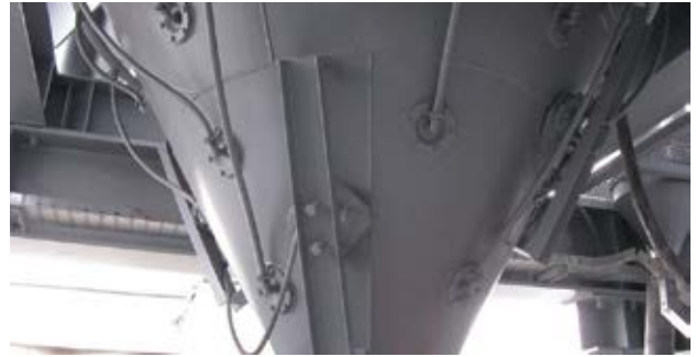
System aeratorów grzybkowych. Źródło: WAM Polska
