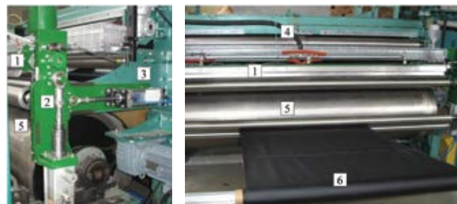
Rys. 8. Układ zabudowy głowicy dozującej wraz z mechanizmami pozycjonującymi w maszynie laminującej: 1 - głowica dozująca, 2 - układ pozycjonowania głowicy, 3 - wspornik maszyny laminującej, 4 - instalacja doprowadzająca elastomer, 5 - walce układu technologicznego, 6 - łączona tkanina
